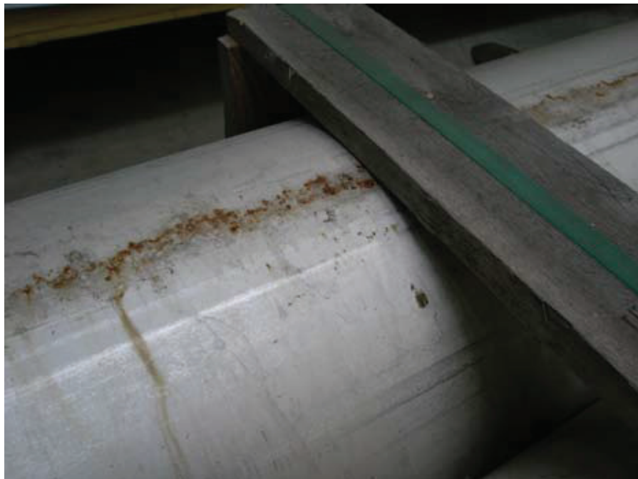
Рис. 7. Труба из нержавеющей стали 316, сильно загрязнённая стальной решёткой на строительной площадке.
