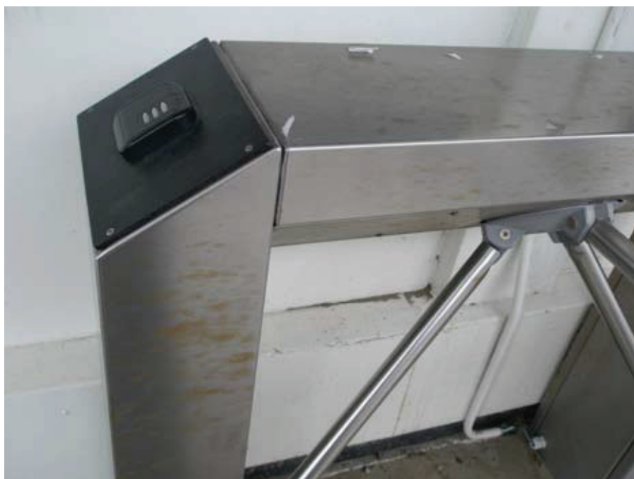
Рис. 2. Контрольно-пропускные ворота RVS316, повреждённые аэрозолями.
