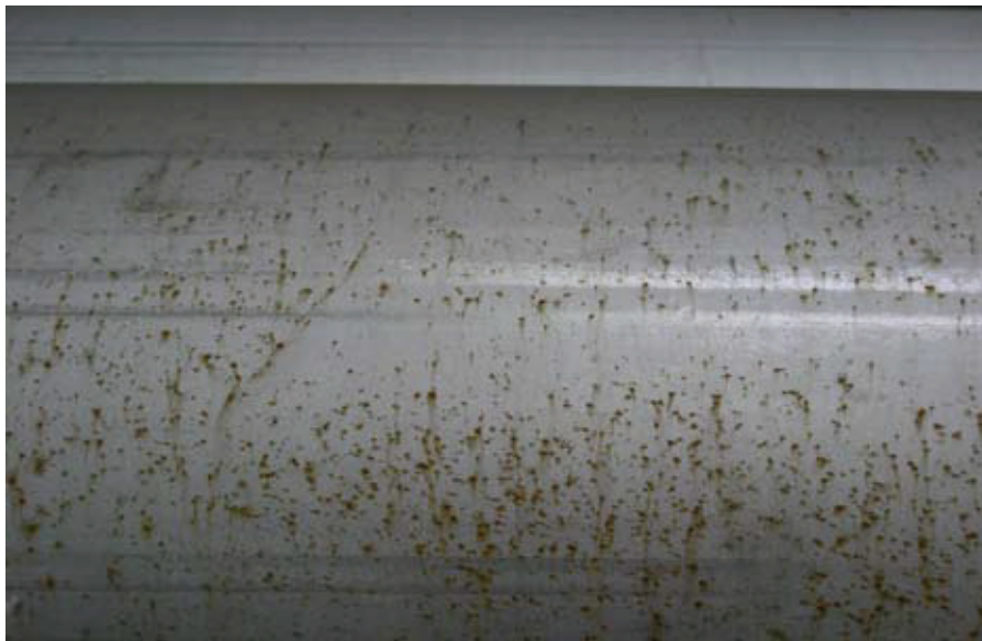
Рис. 1. Коррозия при загрязнении труб из нержавеющей стали, вызванная шлифовкой углеродистой сталью.
